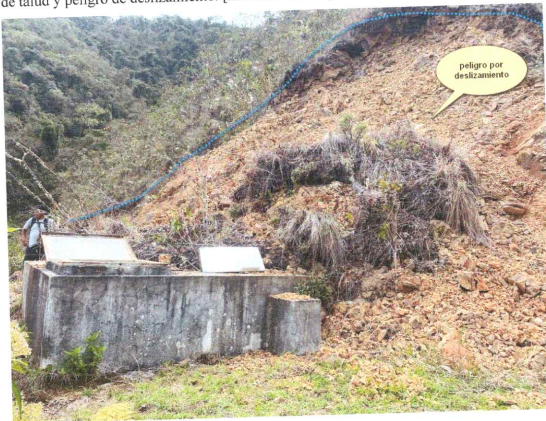
161 Foto 06: Infraestructura de concreto (cámara/tanque) en riesgo directo por inestabilidad de talud y peligro de deslizamiento. [noviembre/2024].
