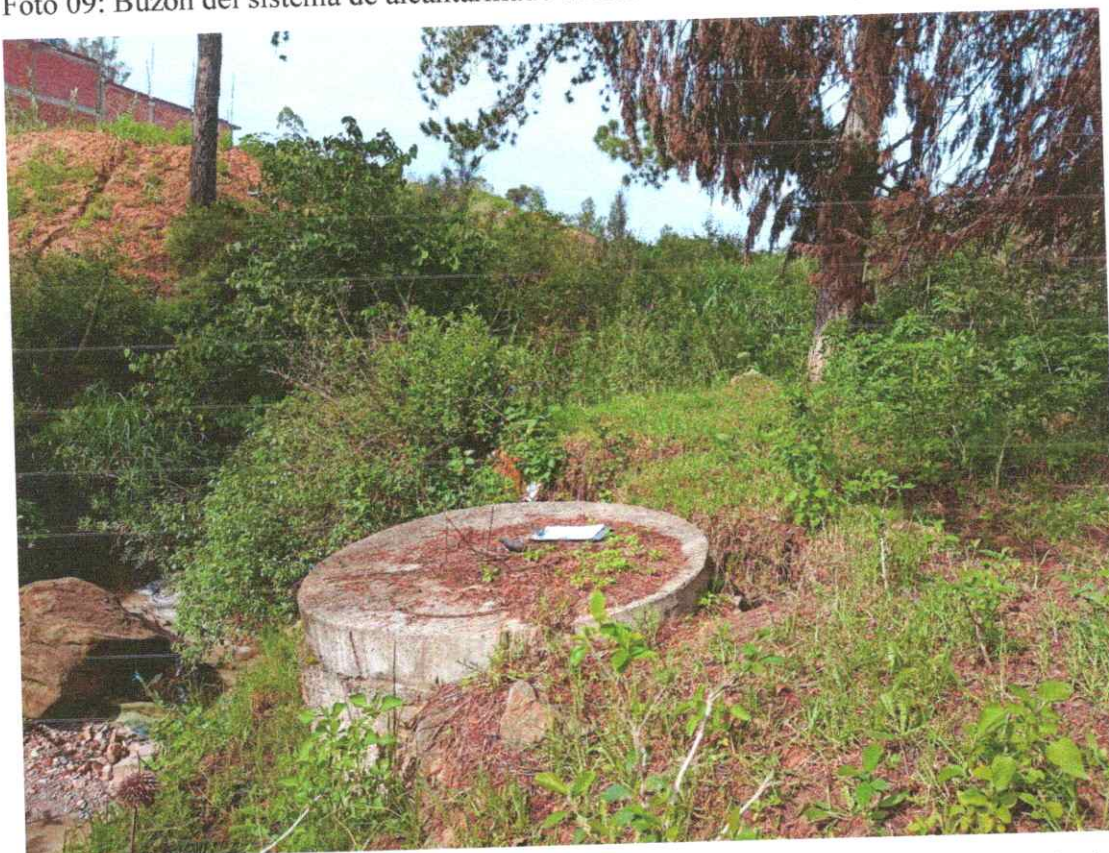
Foto 09: Buzón del sistema de alcantarillado ubicado en zona de riesgo. [enero/2023].
