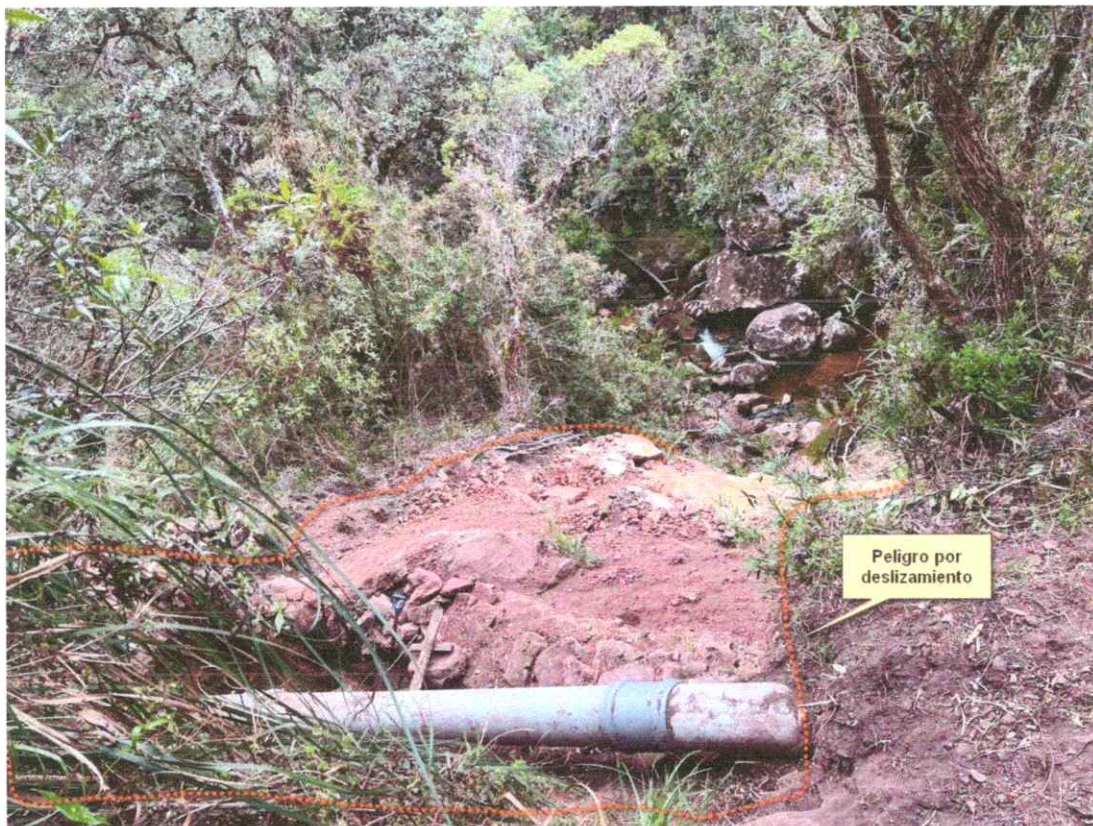
Foto 02: Tubería de la línea de conducción expuesta y zona con peligro de deslizamiento. [noviembre/2024].
