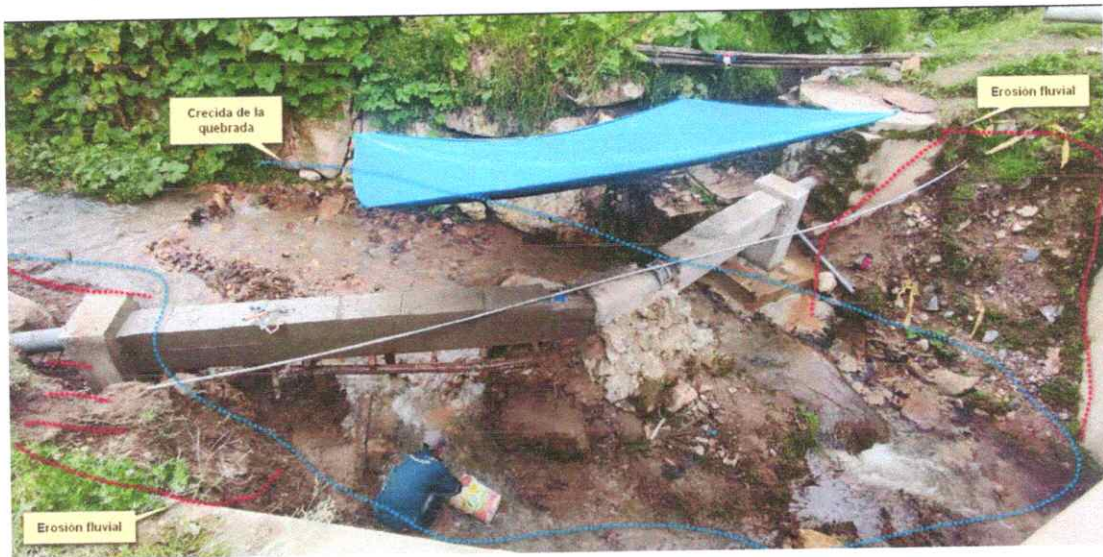
Foto 03: Erosión Fluvial Activa y Crecida de Quebrada - Amenaza Inminente para Buzón y Tubería de Desagüe. [Junio/2025].
