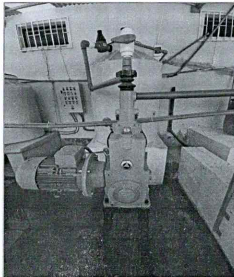
Dosificador de Sulfato de Aluminio
